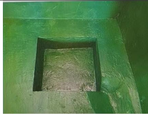
危废间收集池
